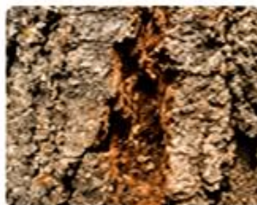
ひび割れ・食害痕
