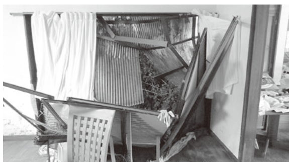
土砂崩れにより、窓を突き破って侵入した土砂 建物の修繕や安全対策には多額の費用がかかり、個人負担での対応は厳しく、公的支援が必要！
