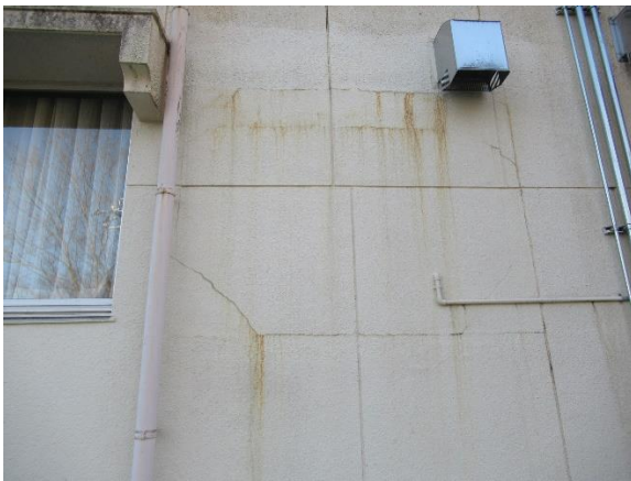
【本庁舎2階外壁（亀裂）】
