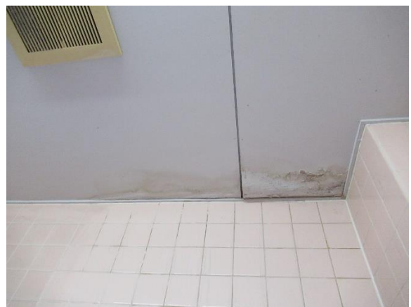
【本庁舎女子更衣室天井（雨漏り）】
