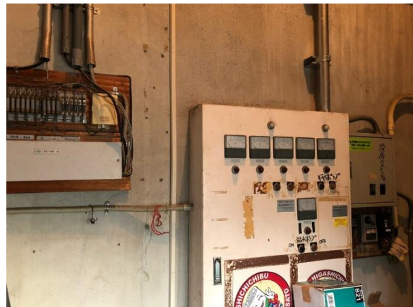
【庁舎電気設備（老朽化）】
