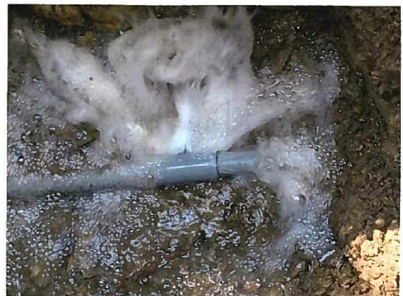
写真.漏水状況
