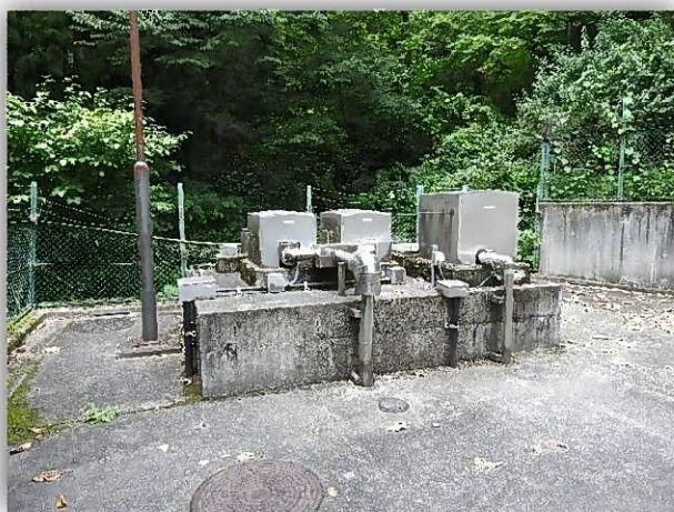
写真.浅井戸ポンプ設備
